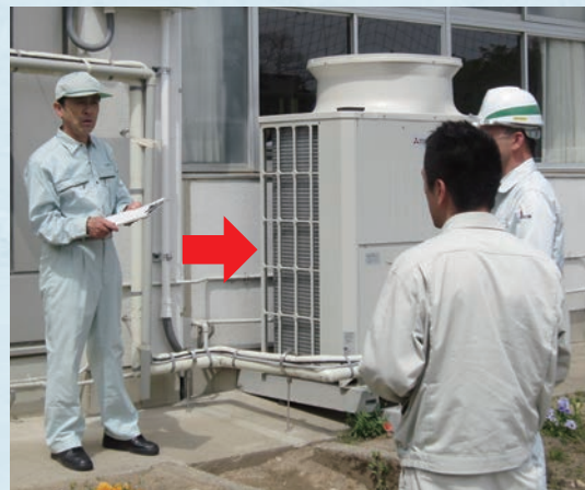
川崎小にはテラスがないのでマルチ型の屋外機。これが垂直に1階から3階までの教室を賄うことになる。
