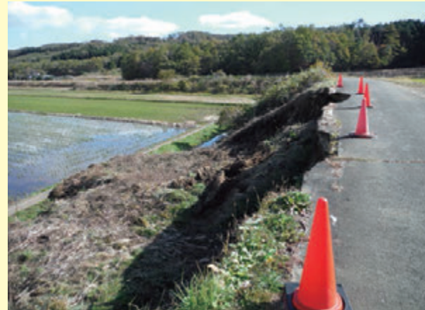
▲農道の法面が崩落したことにより舗装まで損傷しました。 (農道宮脇線：支倉)
