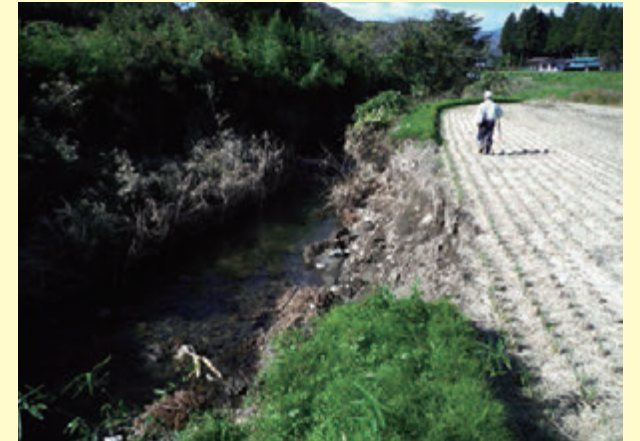
▲増水により農地畦畔が崩落しました。 (大森地区：前川)
