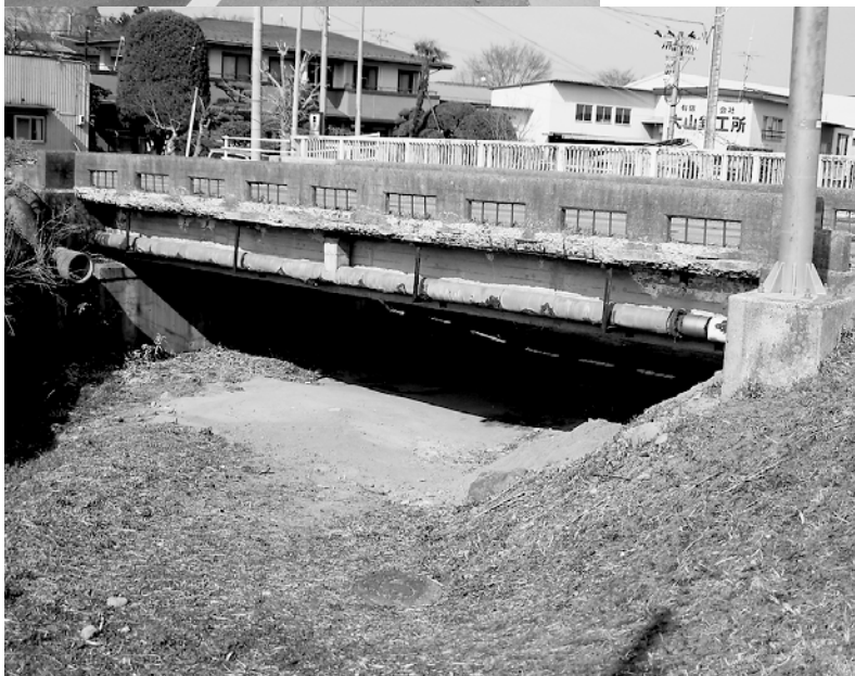
▲傷みが激しい川内橋
