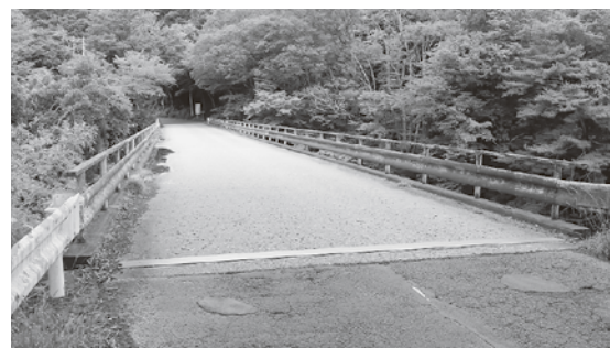
▲補修が待たれる蛙岩橋
