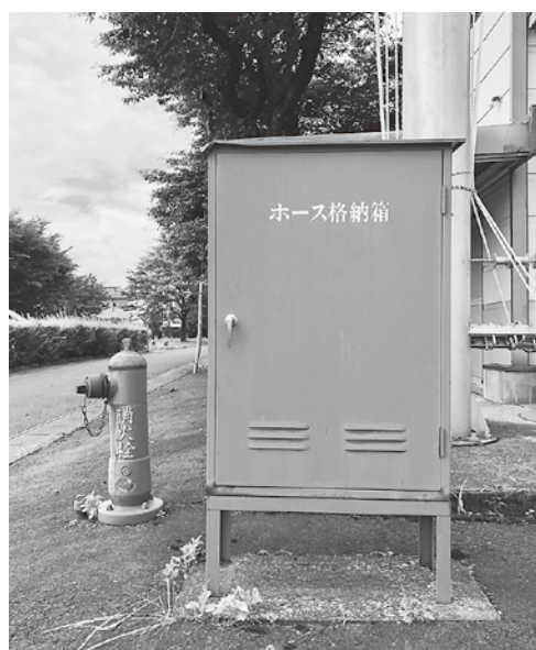
▲町内全域で118基設置
