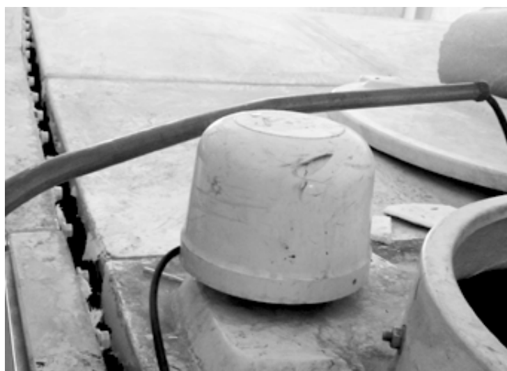
▲破損した源泉槽
