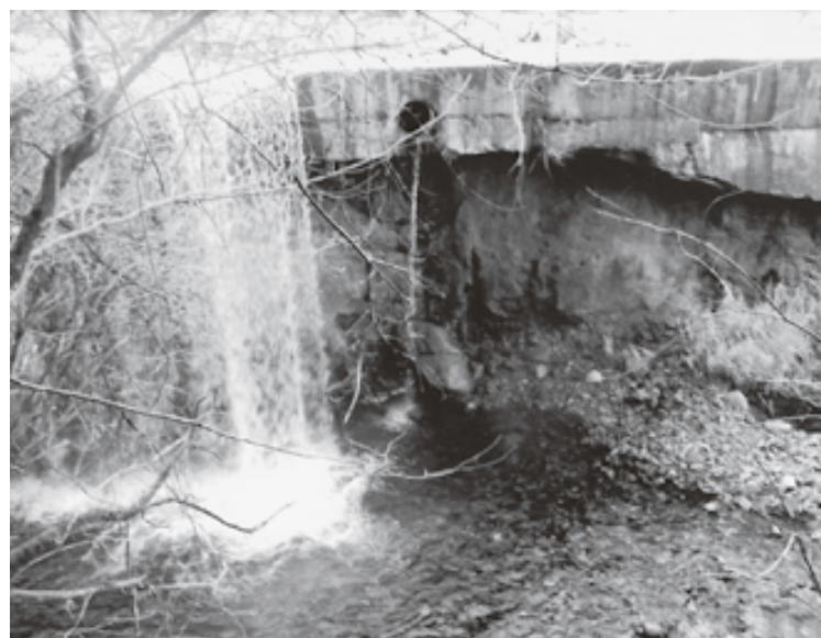
▲下流側が大きく洗掘された河床路
